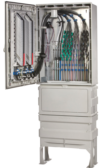
▲ KVz22 Gf-NVt L 2.8 mit Sockelklappe ohne Spleißhaube
